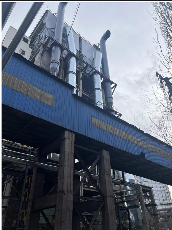
喷煤系统-工艺系统放散口
